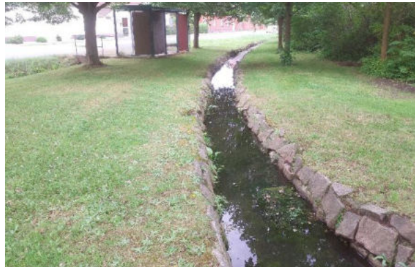
Befestigter Graben an der Hauptstraße in Lugau
