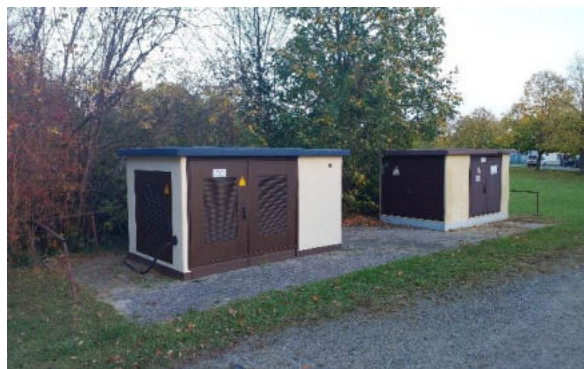
Trafohäuschen in Lugau
